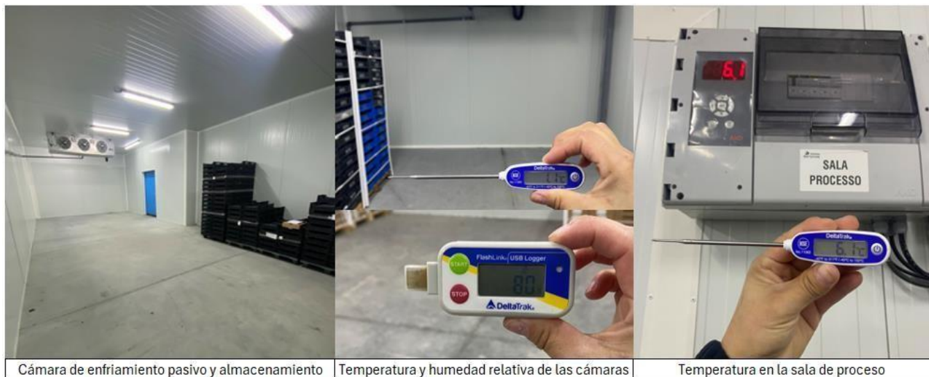
Cámara de enfriamiento pasivo y almacenamiento
